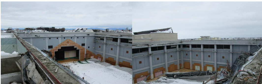
写真 市民総合体育館屋根崩落事故
