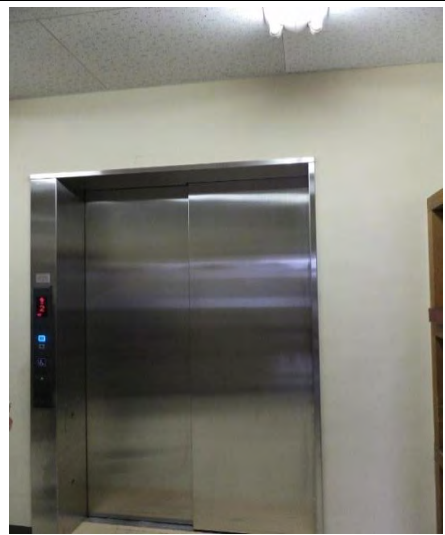
②配膳室（荷物用エレベーター）
