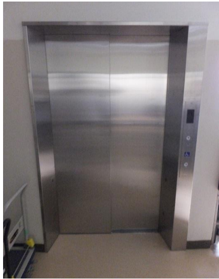
②配膳室（荷物用エレベーター）
