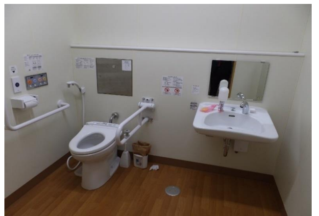
⑦バリアフリートイレ（第1技術科室付近）
