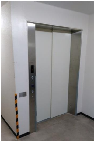
①配膳室エレベーター（物資置き場）
