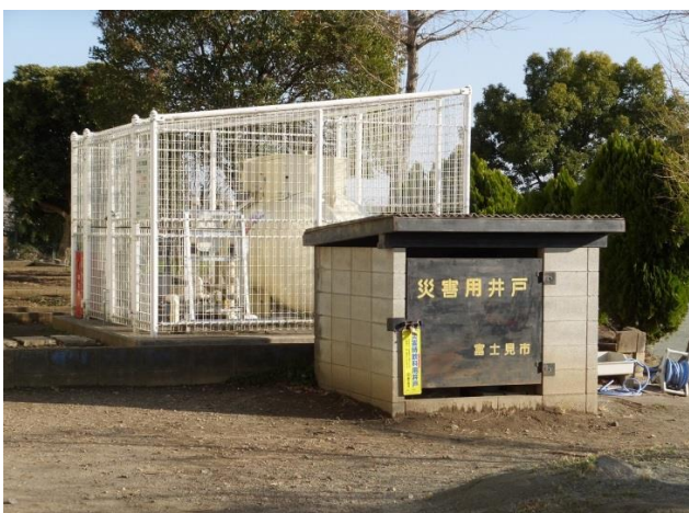
⑤災害用井戸・ガスバルク
