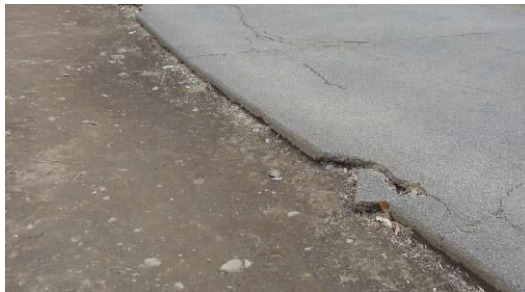
図 113 園路の段差と損傷（学習広場付近）
