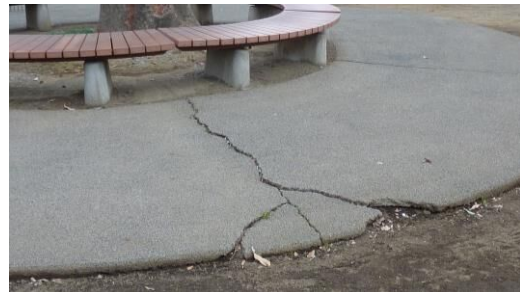
図 114 園路の損傷とサークルベンチの段差
