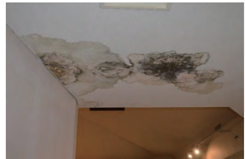
第 73 図 雨漏りによるシミ
