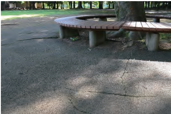
第 76 図 根上りにより破損した園路
