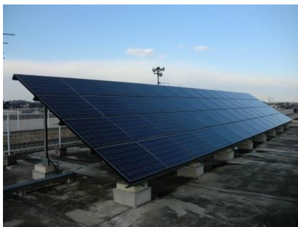
つるせ台小学校に設置された太陽光パネル
