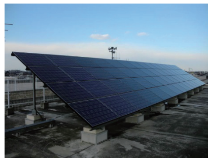
学校に設置した太陽光パネル
