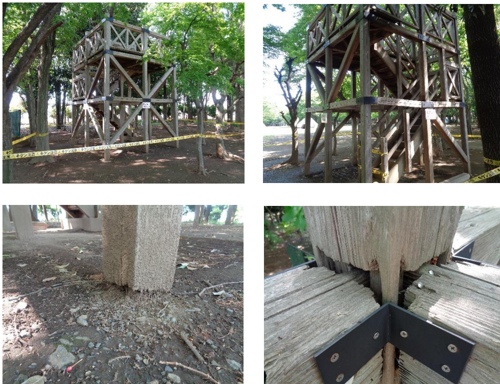
第77図 展望台全景（左上）と劣化部分（右上下、左下）
