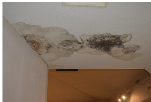
第 72 図 雨漏りによるシミ
