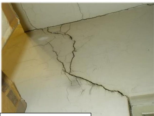
参考写真①（内壁ひび割れ）
