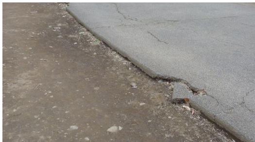
図 113 園路の段差と損傷（学習広場付近）
