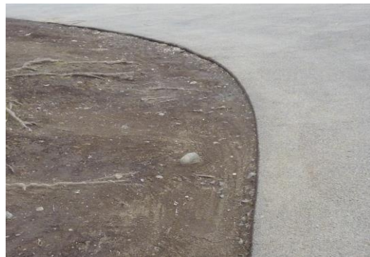
図90 雨水による盛土の流出
