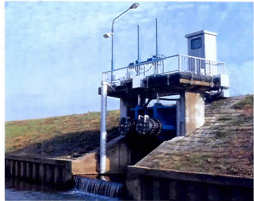
桜井ポンプゲート
