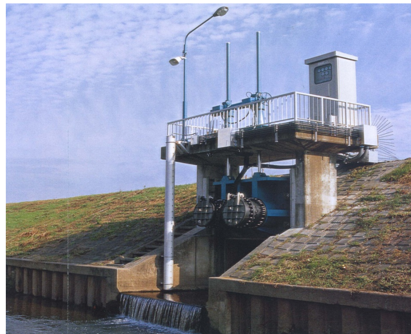
桜井ポンプゲート
