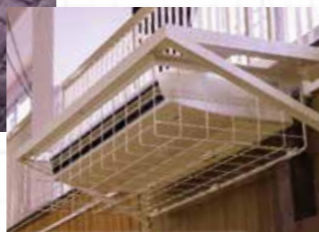
小中学校体育館の空調設備
